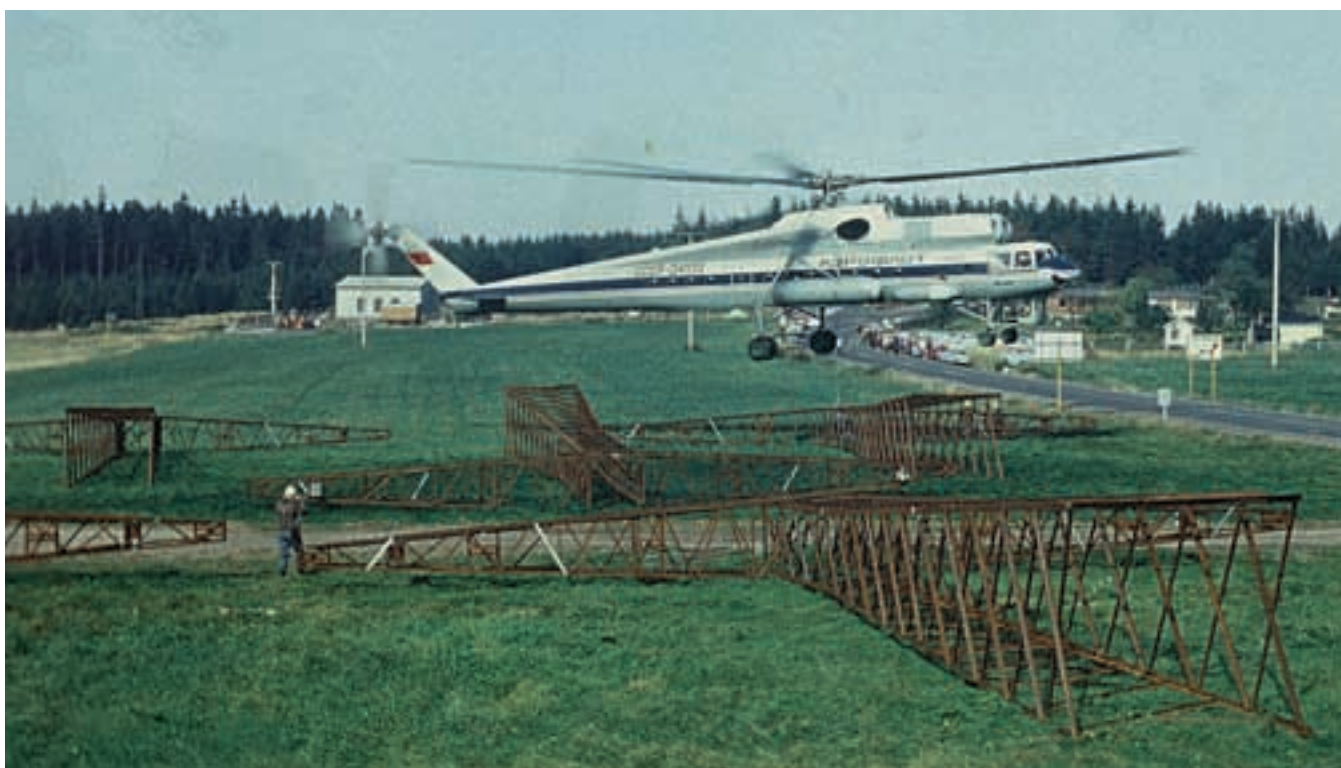
Der Arbeitsflugplatz (AFP) und die Mastvormontage in Neuhaus am Rennweg in Thüringen
